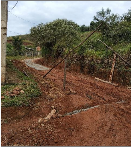
QUADRO 54 – FALTA DE PAVIMENTAÇÃO NO BAIRRO DA BOCAINA FONTE: ACERVO DO AUTOR, 2023
